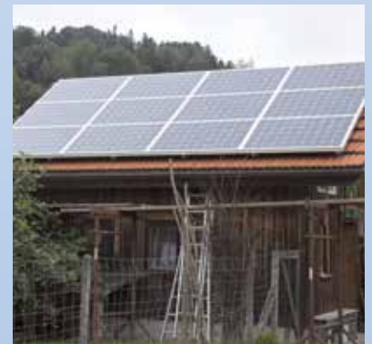
Gartenhaus, 8355 Aadorf Solarstrom 3 kWp
