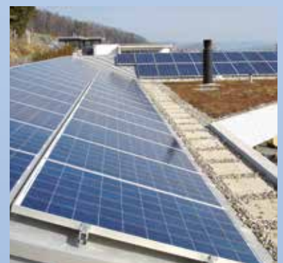
Einfamilienhaus, 8413 Neftenbach Solarstrom 12.75 kWp
