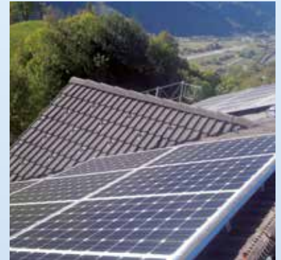
Einfamilienhaus, 3938 Ausserberg Solarstrom 7 kWp
